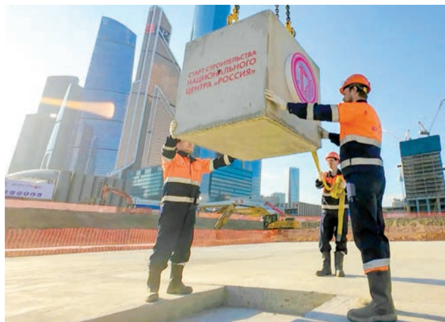
Строители заложили камень в фундамент будущего центра / КАНАЛ МЭРА МОСКВЫ В МЕССЕНДЖЕРЕ МАХ
