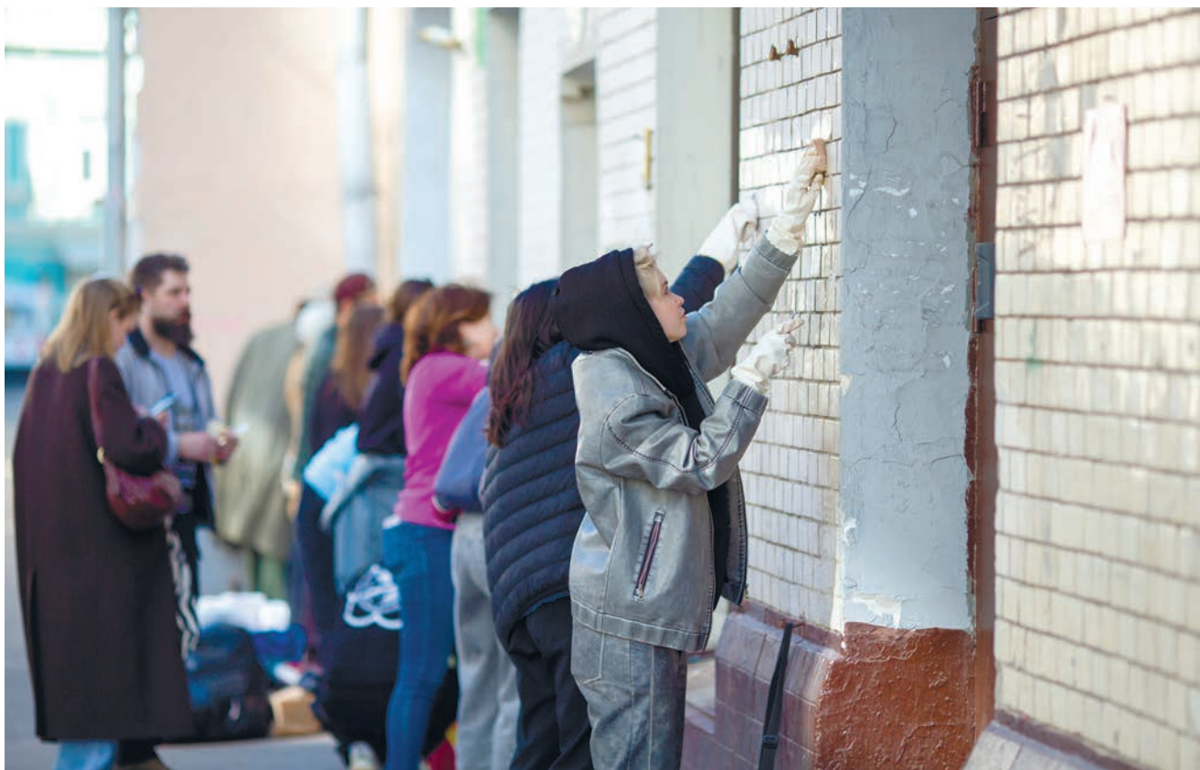
Главная задача волонтеров – не навредить. Работы они проводят не наобум, а по специальным методикам, которые составляет архитектор-реставратор Пётр Шутов. По словам координатора волонтеров, работы на этом участке займут не менее двух месяцев / ВСЕ ФОТО: ОЛЬГА КАРАСЕВА
